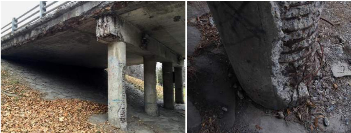
Dégradation avancée des ponts d'étagements Remembrance \ Chemin de la Côte-des-Neiges Photos DC
